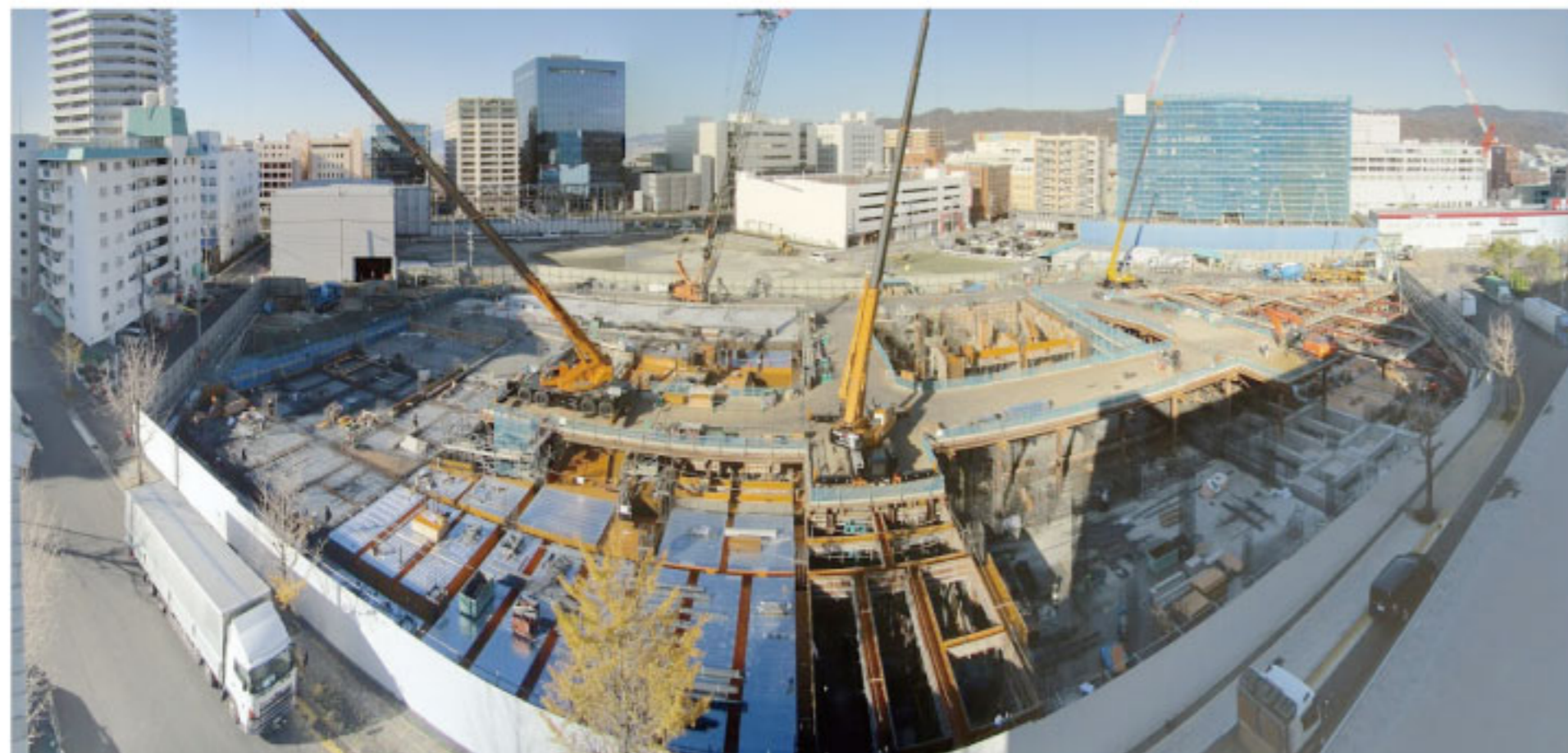
②おたふく手袋屋上から「駅前再開発地区」を望む(市民ホール、図書館)
